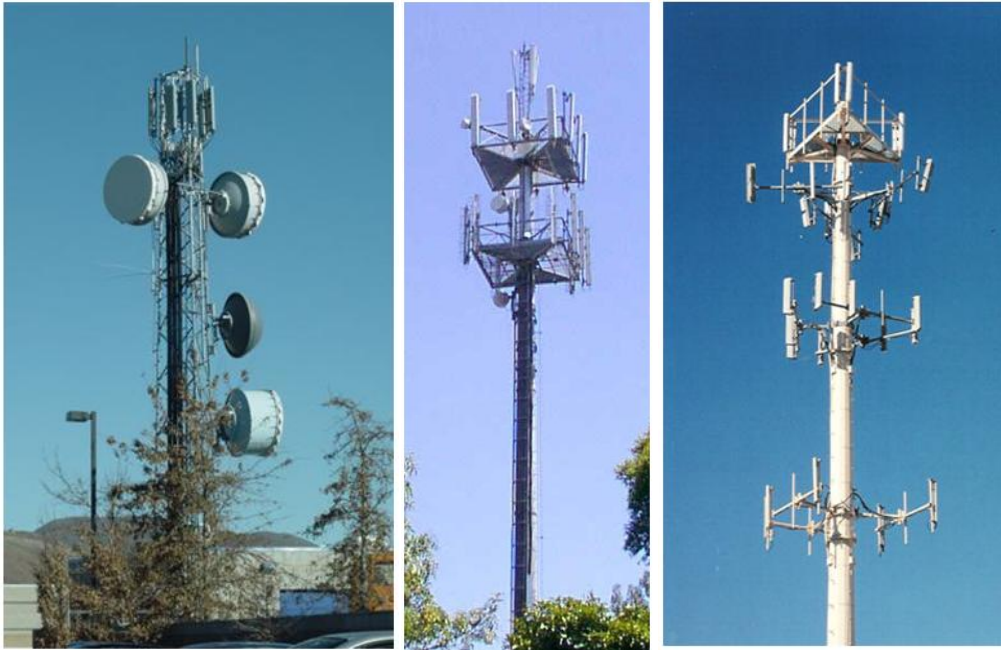
Figura 1 Torres y antenas de telecomunicaciones típicas [6].
